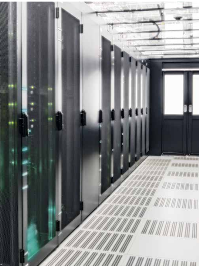
Das Twin Data Center ist das Herz von Dataport.
